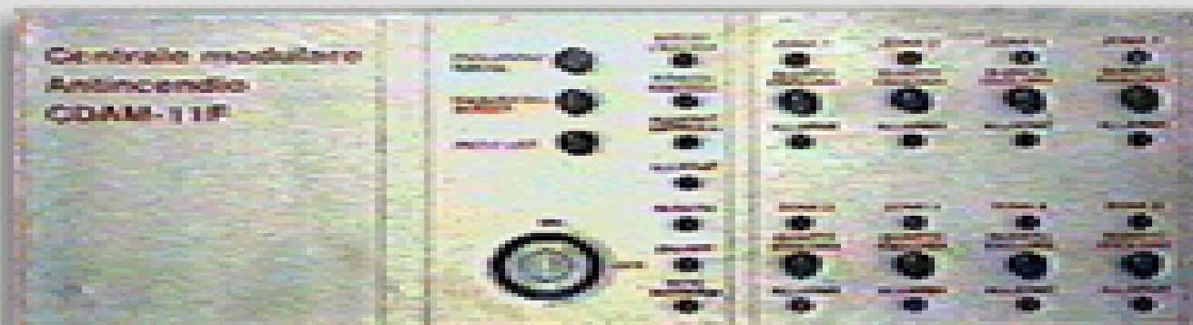
centrale di controllo e segnalazione
